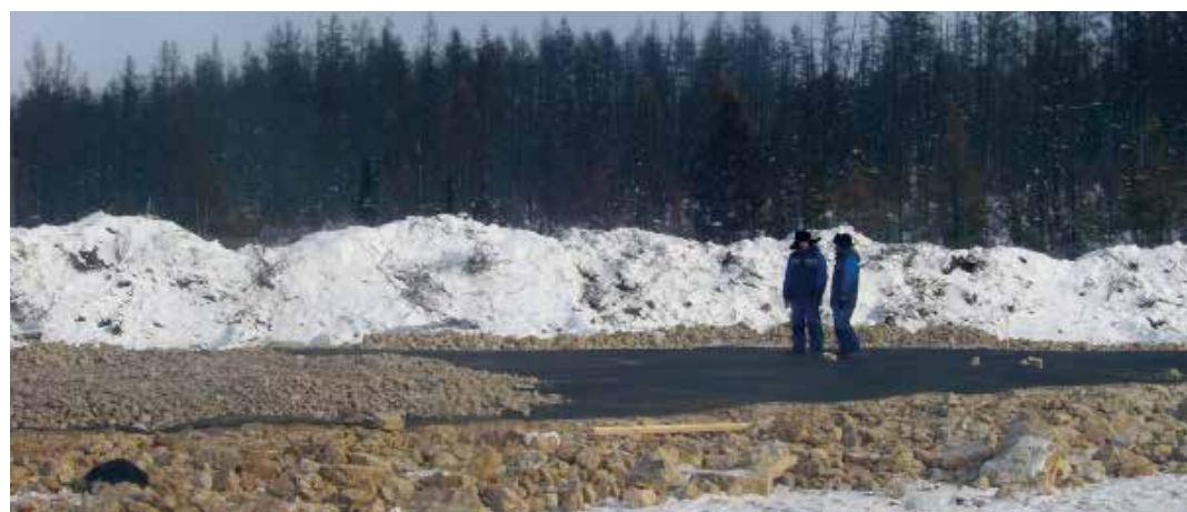
Укладка георешетки Тенсар на строительстве дороги в регионе при температуре ниже -50°C. Северобайкальском
